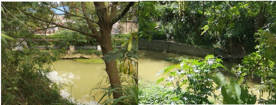
畴阳河堤防堤脚掏空（兴街镇林家段）
