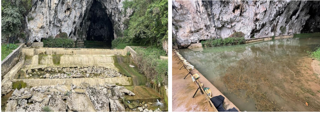
岔河燕子洞溢流堰损毁（左）及溢流堰前淤积（下）
