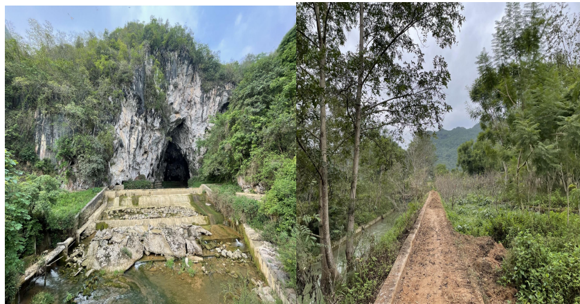
岔河（燕子洞）洞口溢流堰修复前 岔河（燕子洞）堤坝道路修复前
