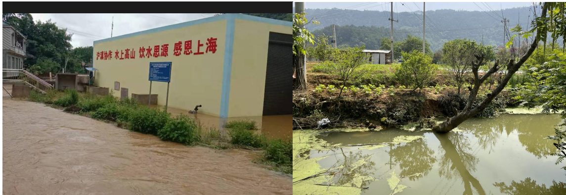
南丘河河沿局部河段冲刷
