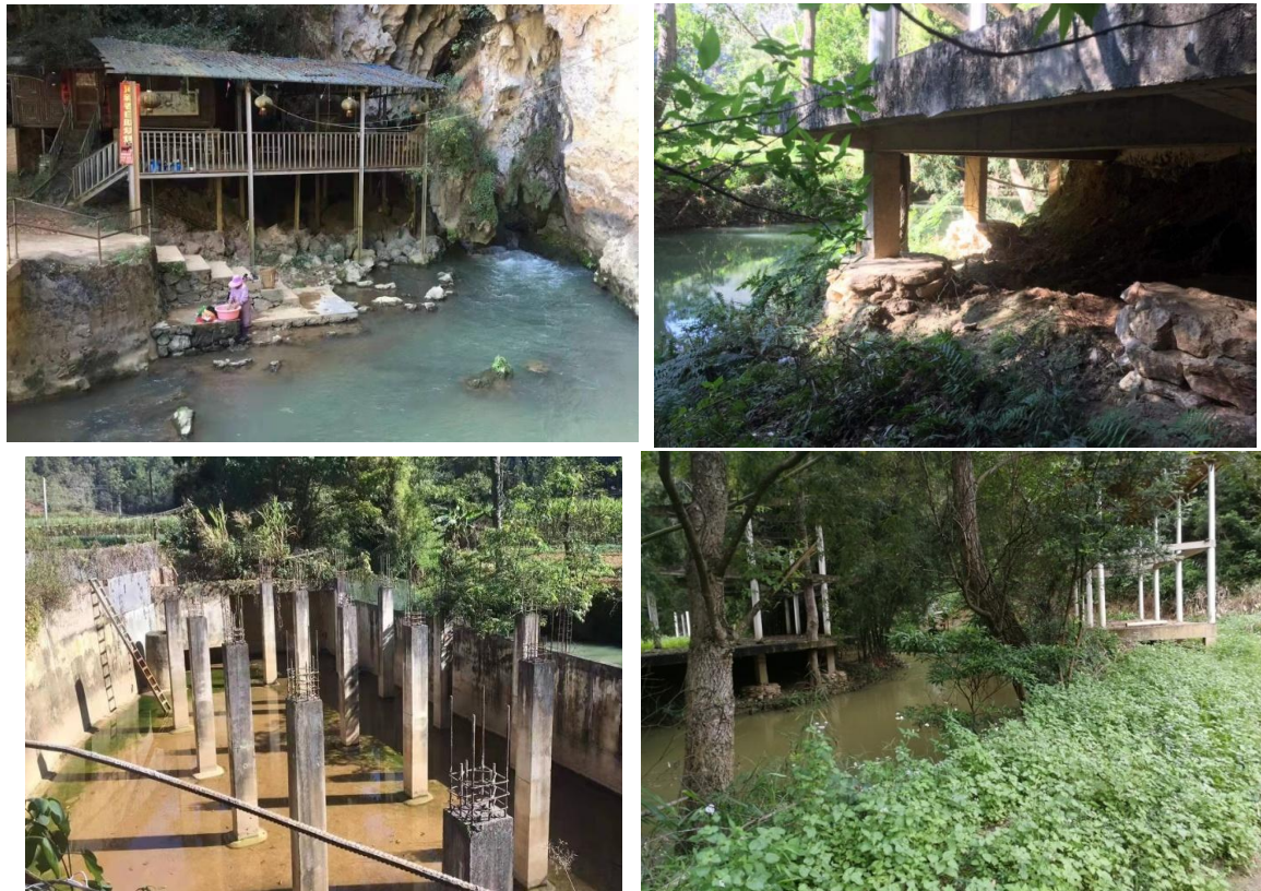
侵占河道行洪断面的违建
