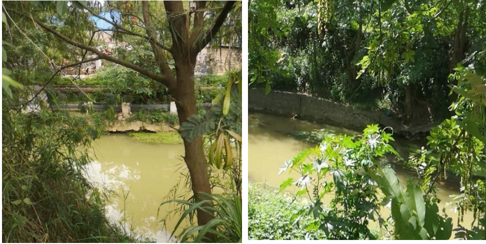
图 3-3 畴阳河堤防堤脚掏空（兴街镇林家段）
